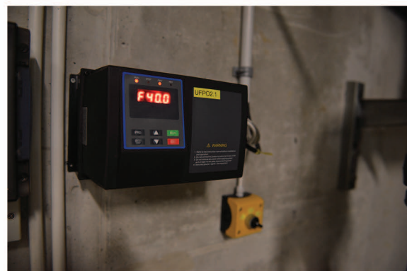
Montaż falowników do pomp obiegowych umożliwia płynną regulację ich wydajności.
